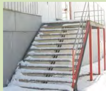
Abb. 32: Vereiste Fluchttreppe [Quelle: ikl]
